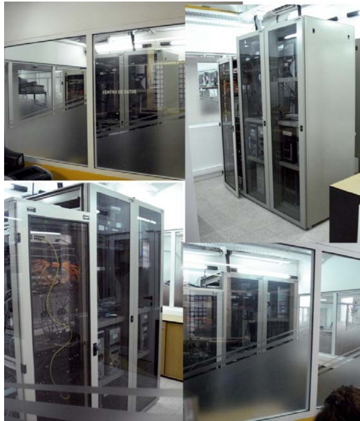
Nuevo centro de datos en el 8vo piso
