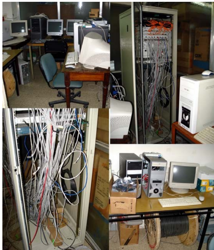
Centro de datos en el 5to piso
